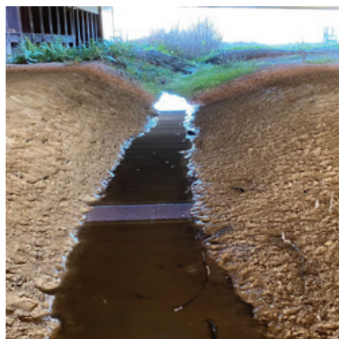
Foto 6: De faunapassage wordt veel gebruikt door dieren. De betreding is goed te zien aan de vele sporen aan weerszijden van het water.
